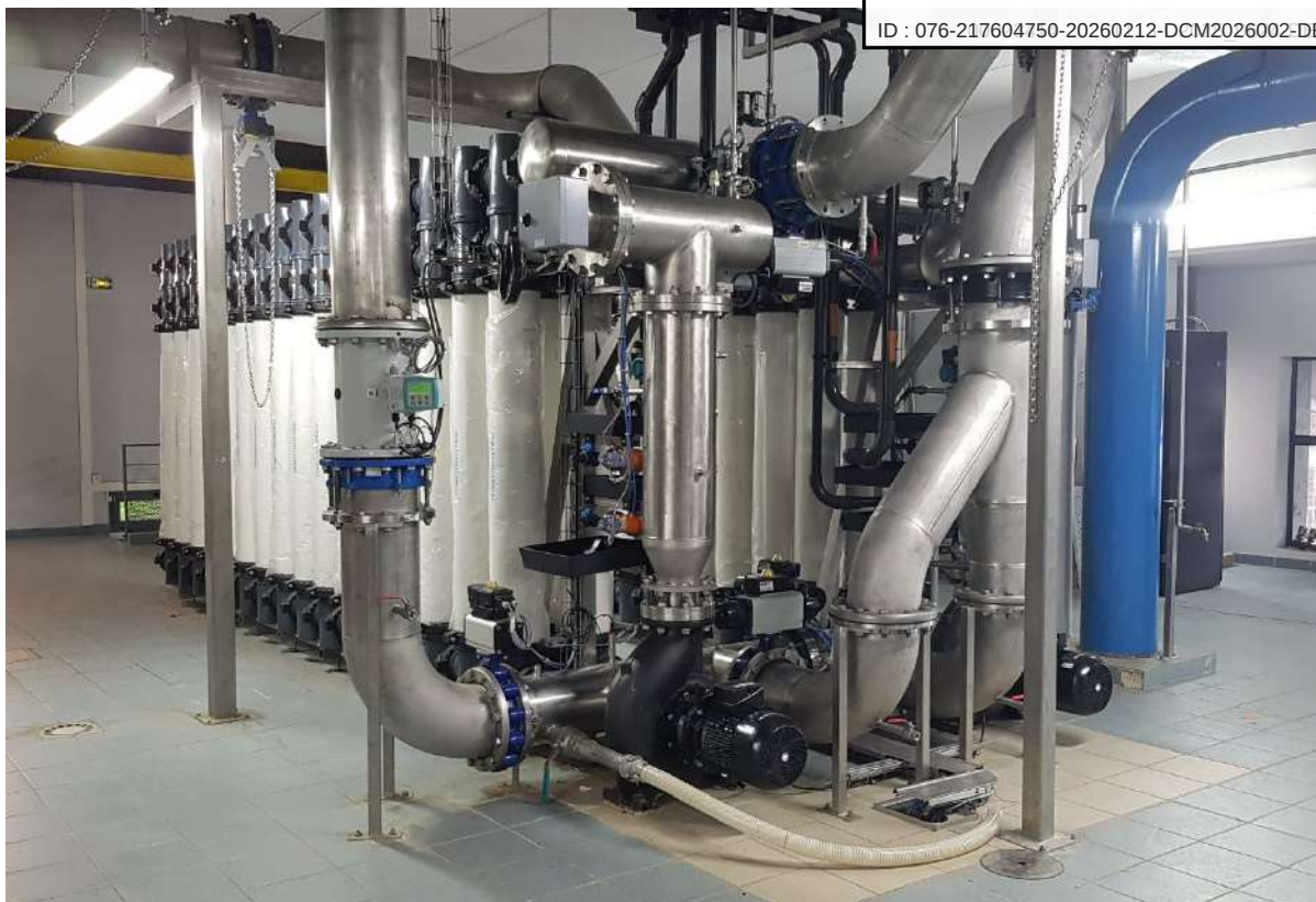
Unité d'ultrafiltration – Usine de la Jatte ROUEN
