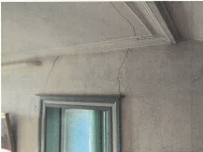
Fissures sur l'enduit mural
